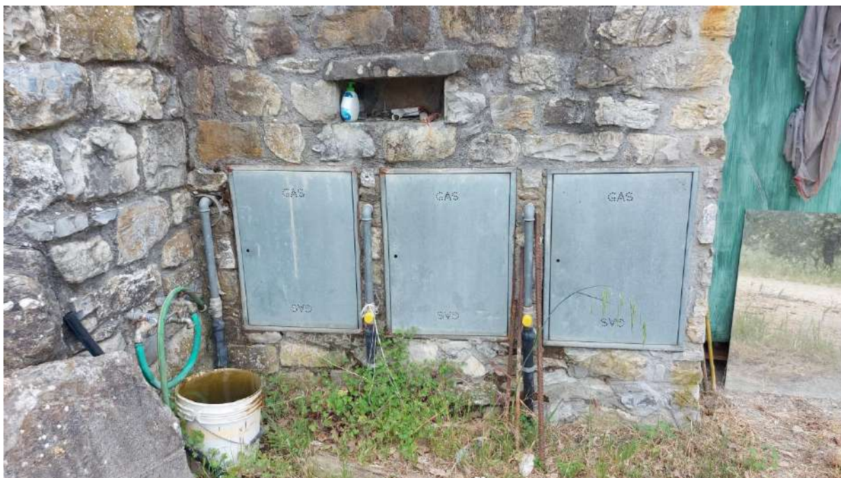
Foto 65: Tettoia – utenze gas
