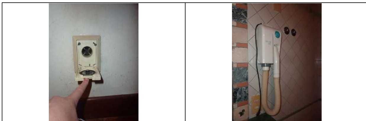
Foto 204: Impianto di aspirazione polvere e impianto phon
