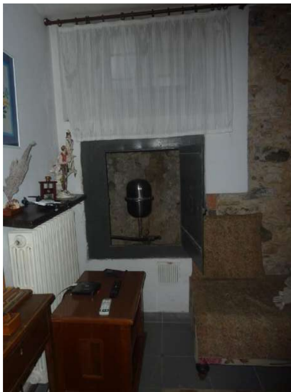
Foto 131: Villa – piano seminterrato 1° – sala biliardo – nicchia autoclave
