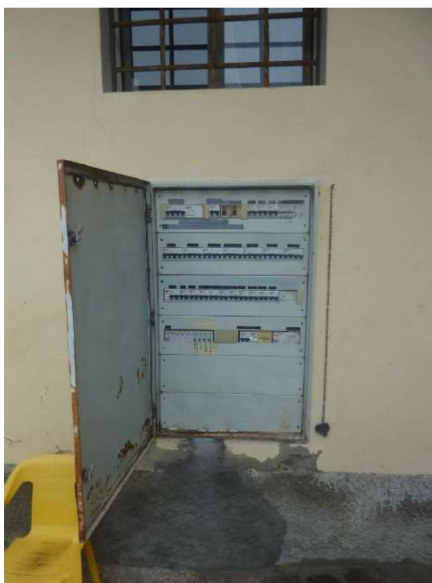
Foto 56: Villa/dépendance – quadro elettrico generale
