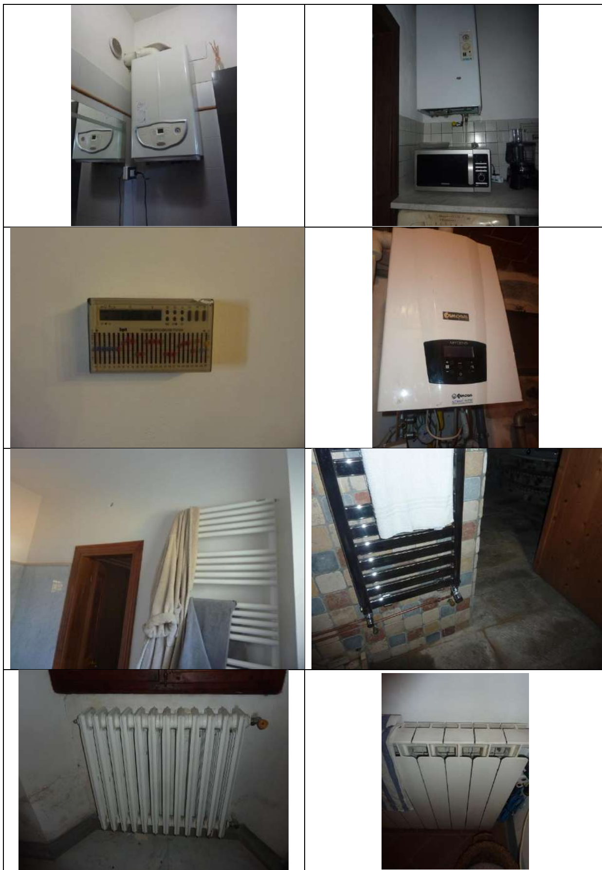
Foto 206: Impianto di riscaldamento e acqua calda
